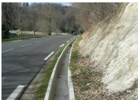
Figure 90 : Collecteur en U. Source: © Conseil départemental de l'Isère
