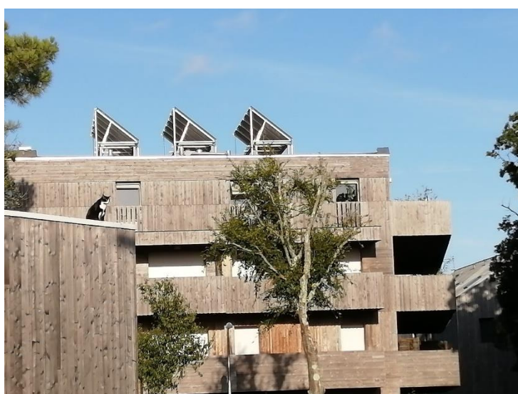
Figure 75 : Installation solaire en toiture
