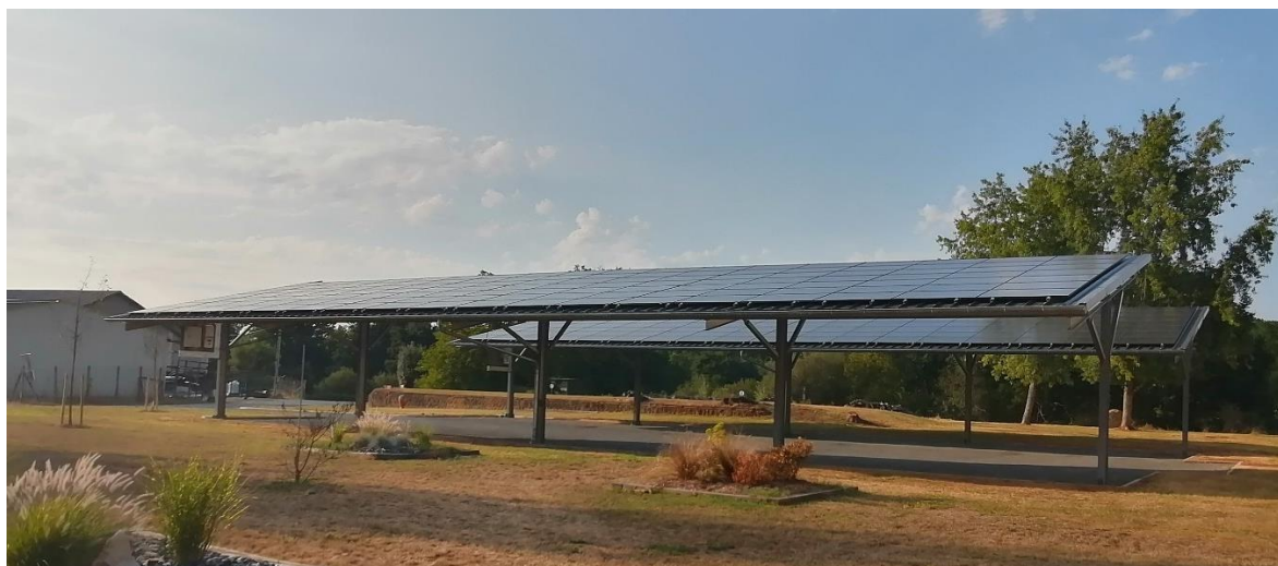
Photographie 1 : Ombrières photovoltaïques pour vélos et voitures
