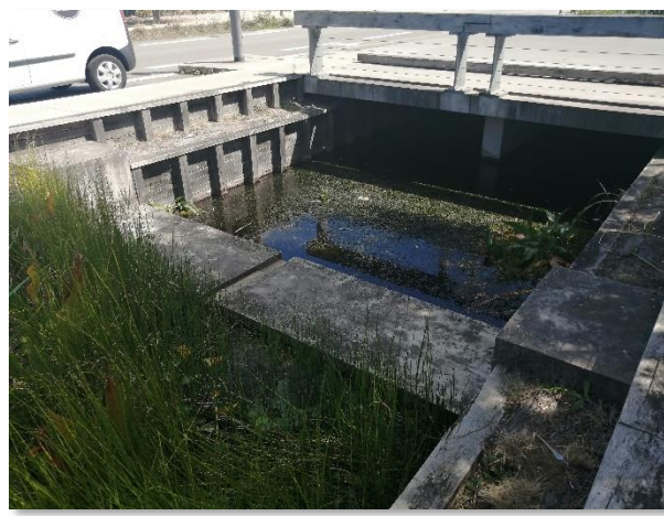
Figure 22 : Bassin en eau – La Bottière Chênaie à Nantes Source : Sylvain LE ROUX, ENCIS ENVIRONNEMENT
